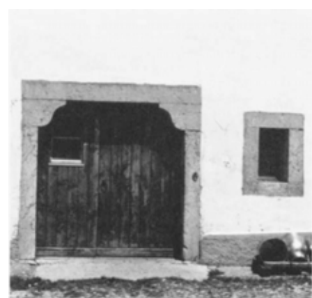
Les Rouges-Terres. Cadres de porte et de fenêtre correctement rénovés. Pas d'enjolivures. Le crépi affleure (à pierre; il est droit et en retrait de 12 à 15 cm des ouvertures.
