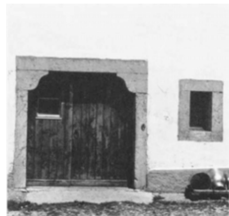
Les Rouges-Terres. Cadres de porte et de fenêtre correctement rénovés. Pas d'enjolivures. Le crépiçage affleure (à pierre; il est droit et en retrait de 12 à 15 cm des ouvertures.
